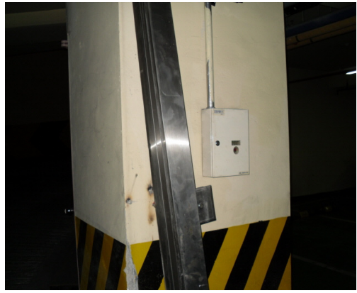
▲ 방화셔터 레일이 파손된 상태로 방치한 경우
