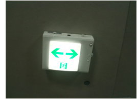
▲ 통로유도등이 올바르게 설치된 경우
