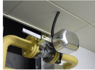
▶ 가스누설경보기의 차단밸브가 설치된 사례
