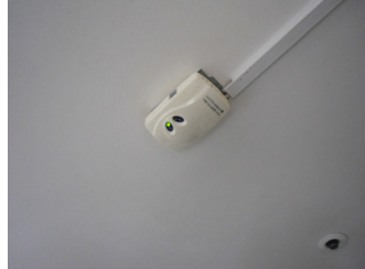
▶ 가스누설경보기의 탐지부가 설치된 사례
