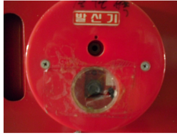
▲ 발신기의 파손을 방지한 경우
