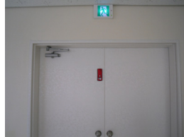
▲ 피난구 유도등이 올바르게 설치된 경우
