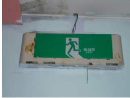
▲ 유도등이 부식되어 점등되지 않는 경우
