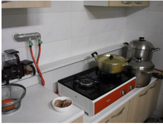
▲ 가스누설경보기가 미설치된 경우
