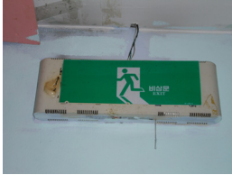
▲ 유도등이 부식되어 점등되지 않는 경우
