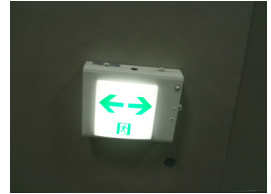
▲ 통로유도등이 올바르게 설치된 경우
