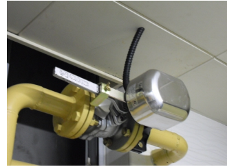
▲ 가스누설경보기의 차단밸브가 설치된 사례
