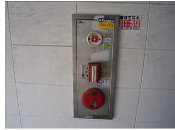
▲ 위치표시등의 파손을 방지한 경우
